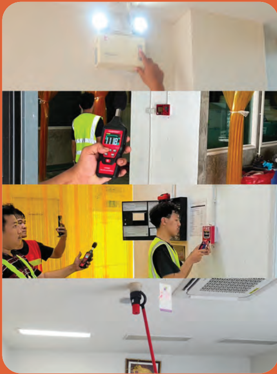
บริการตรวจสอบระบบแจ้งเตือนไฟไหม้
